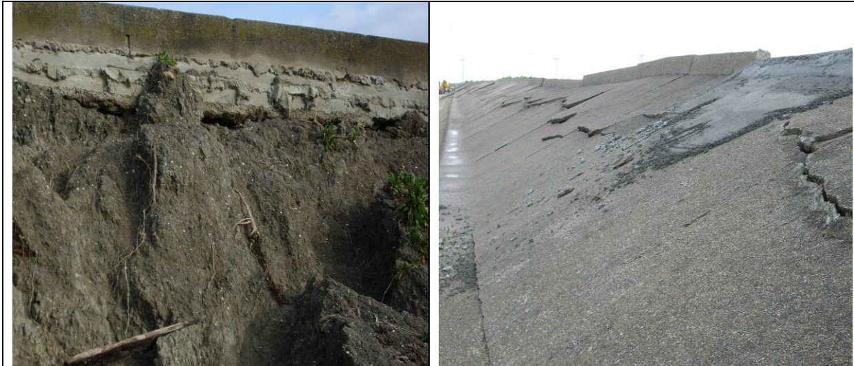
Figure 2.27 – Digue du Bouin : Erosion du remblai par surverse (photo a côté ZP) jusqu'à apparition de vides sous les plaques qui s'affaissent (photo b côté mer) – Source Irstea.
