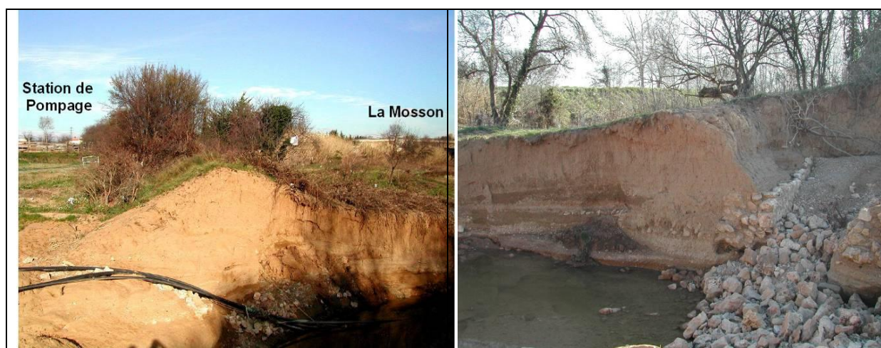
Figure 2.32 – Digue de la Mosson après la rupture : câbles mis en place dans la tranchée et restes de l'ancienne fondation – Source Cerema.
