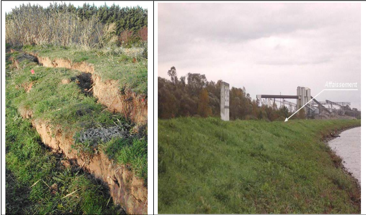
Figure 2.34 : a– Digue de la Mosson rive gauche après glissement du talus ; b- Affaissement de la digue du Rhin de 100 m de longueur sur 40 cm de hauteur – Source Cerema.
