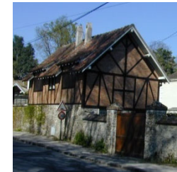
Les pans de bois ne peuvent être enfermés pour des raisons esthétiques et de pérennité (risque de pourrissement du bois)
