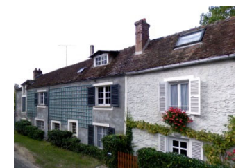
Une surélévation d'une des toitures même de quelques dizaines de centimètres romprait l'uniformité de la ligne de faitage et créerait des lignes de raccordement toujours fragiles.
